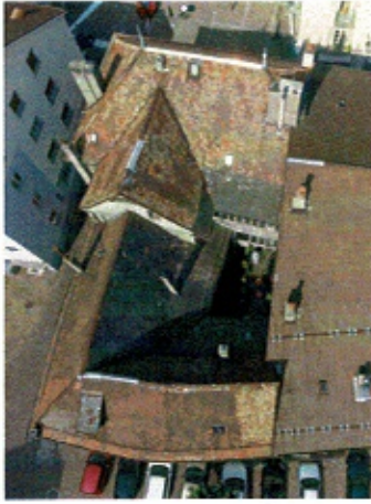
Grand-Rue 74 Toits avant rénovation au-dessus de la cour intérieure
